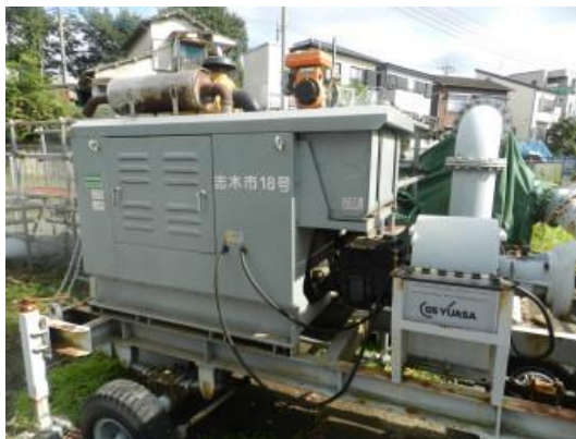
可搬式ポンプの運転
